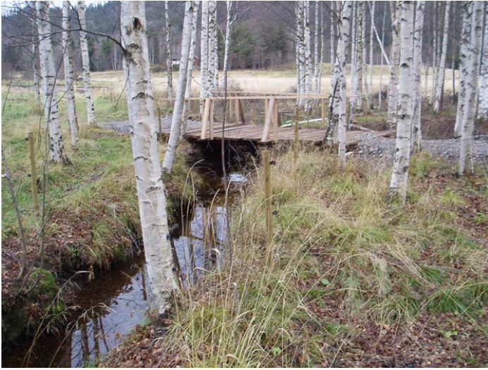
Bild 1. Träbro och stängsel i syfte att hindra kotramp i bäck. Effekten förväntas bli minskad grumling och sedimenttransport till nedströmsliggande flodpärlmusselförande vattendrag.
