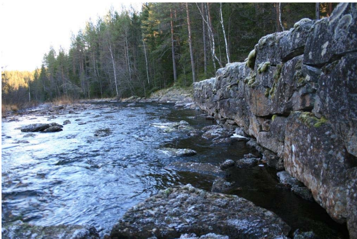
Bjoneelva, Gran kommune. 10.11.2007. Elveforbygging i øvre del. Foto: Geir Høitomt
