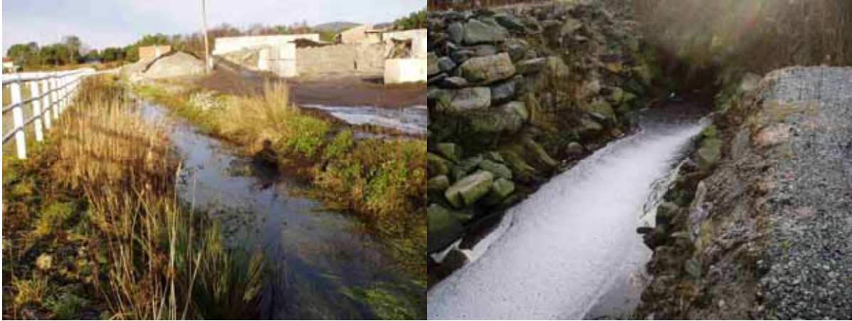
Bilde 3: Bekk fra Travparken. Til venstre litt av anlegget for sortering av jord og stein langs bekkens bredder. Til høyre utløpet av rør under travverbanen. 12.11.03. Foto: A.Hobæk.
