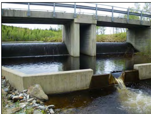
Reguleringsdammen ved utløpet av Åfjorden med vannslipp til Mossa (0,1 m 3 /s) i juni 2010. Foto: Bjørn Mejdell Larsen.
