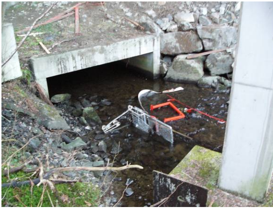
Fig. 3 Inngang til den nederste kulverten: Dårlig ørrethabitat og dessuten mye søppel
