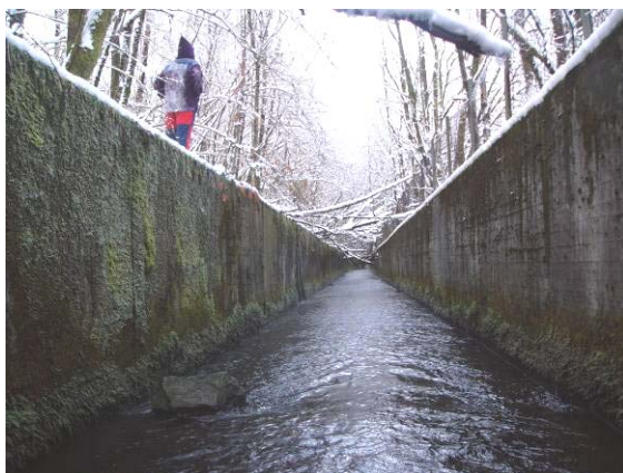
Fig. 7 Den ca. 250 m lange betongkanalen: Svært dårlig habitat for ørret og et vandrehindring under lav vannføring
