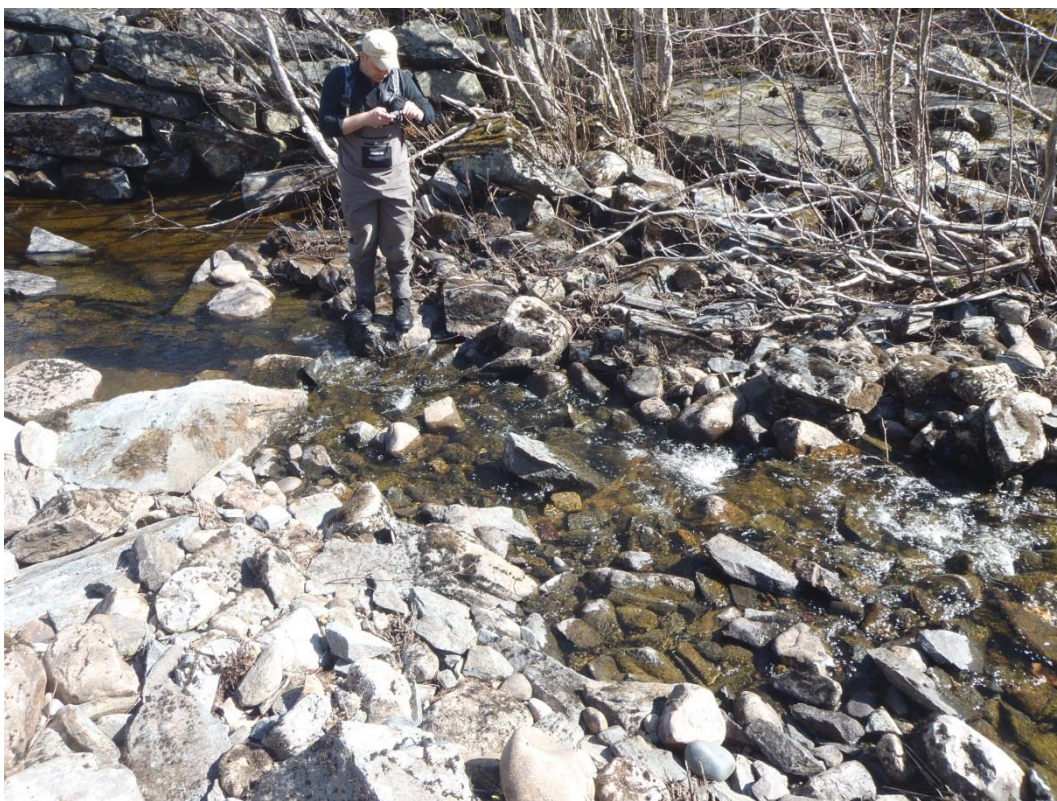
Figur 4-1 Lekkasje fra Teksdalsdammen
