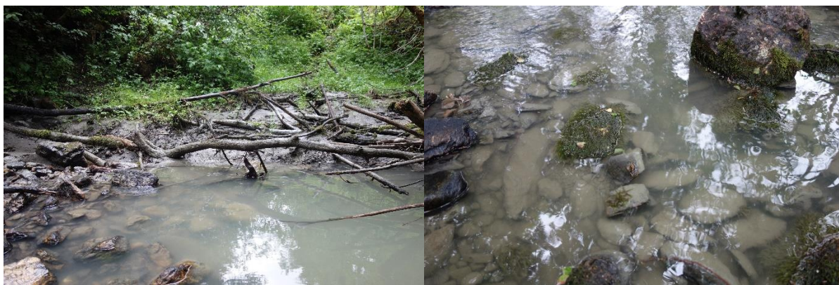
FIGUR 7: TYDELIGE TEGN PÅ LEIRRAS OPPSTRØMS I BEKKEN
