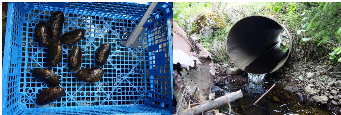
FIGUR 57: NEDRE LOKALISERING AV ELVEMUSLING I ØVRE DEL VAR ISOLERT FRA RESTEN AV BESTANDEN. EN DÅRLIG KULVERT HINDRET VANDRING AV VERTSFISK
