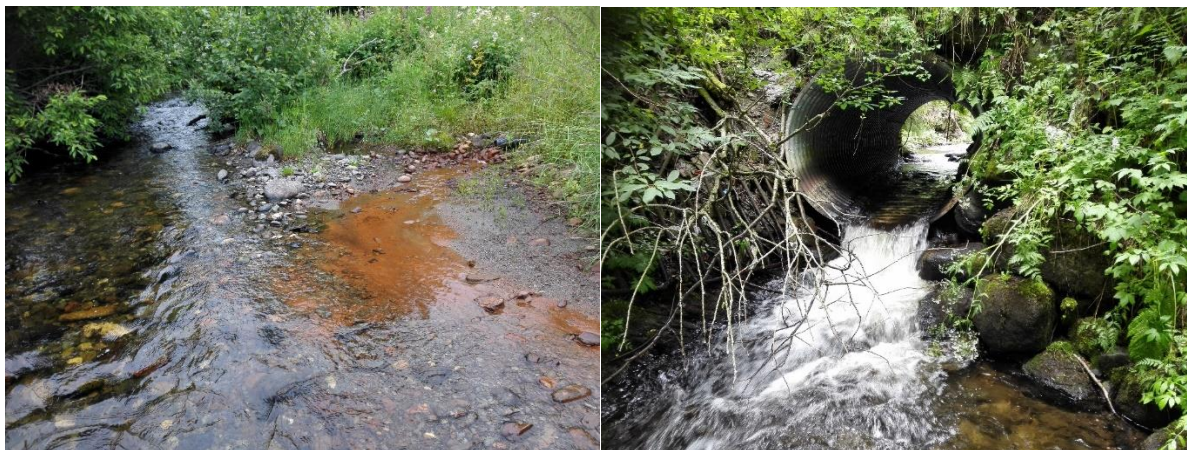
FIGUR 43: AVRENNING OG DÅRLIG KULVERT VED SOLA
