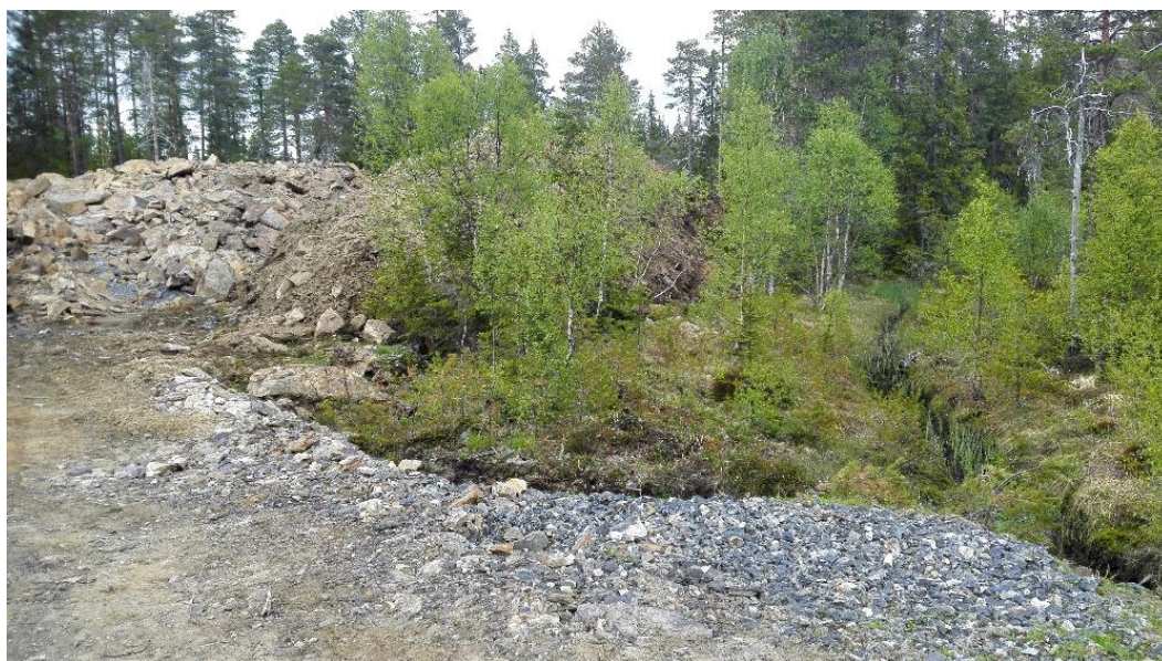
FIGUR 65: ET ANLEGGSSOMRÅDE MELLOM GJØVASSBEKKEN OG MJØVASSBEKKEN KAN VÆRE KILDE TIL FORURENSENDE AVRENNING
