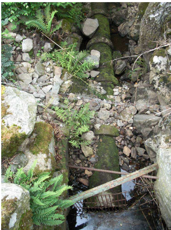
Figur 10. Øverste vandringshinder, rør som ligger i dagen
