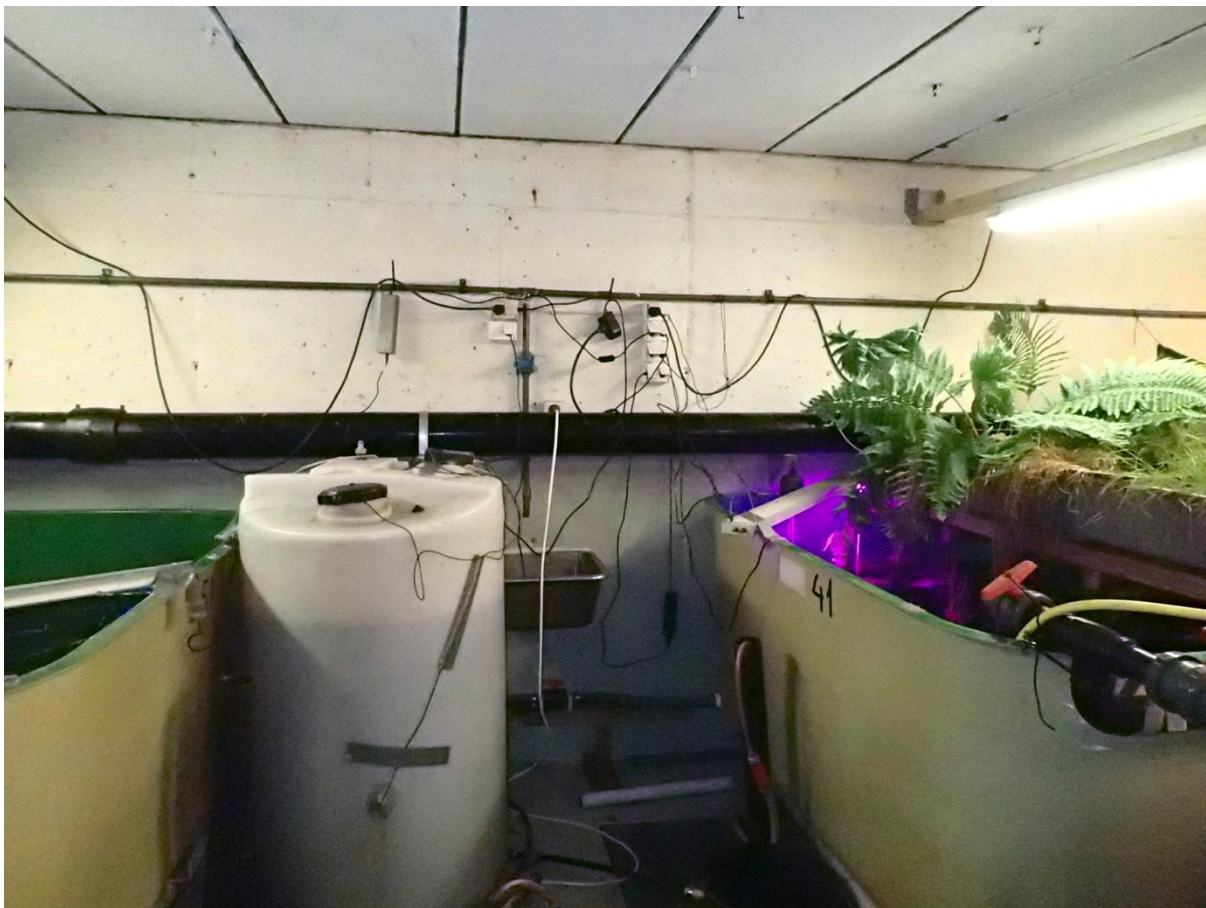
Bildet viser eksisterende vannbehandlingsanlegg for småmuslinger.
