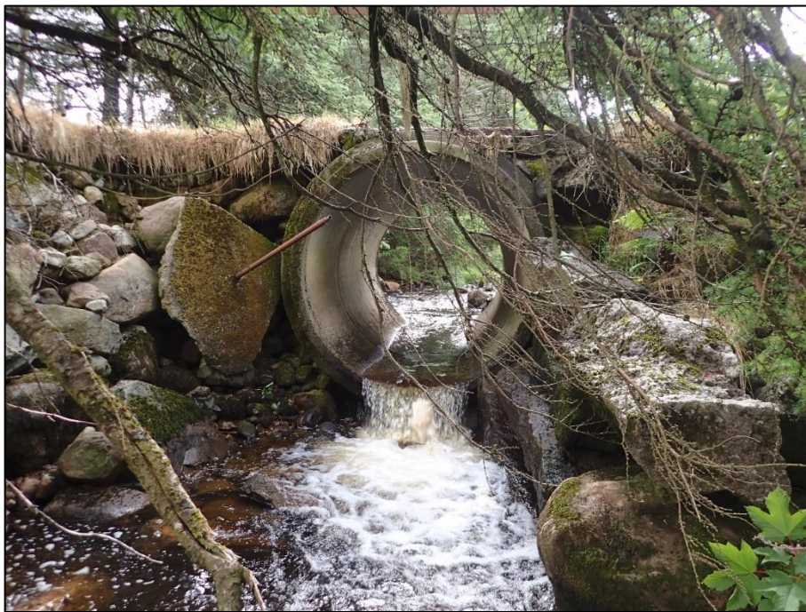
Foto 4. Kulvert ved Ualand. Kulverten fungerer som et vandringshinder for fisk, spesielt ved lav vannføring. Foto: Jon H. Magerøy.
