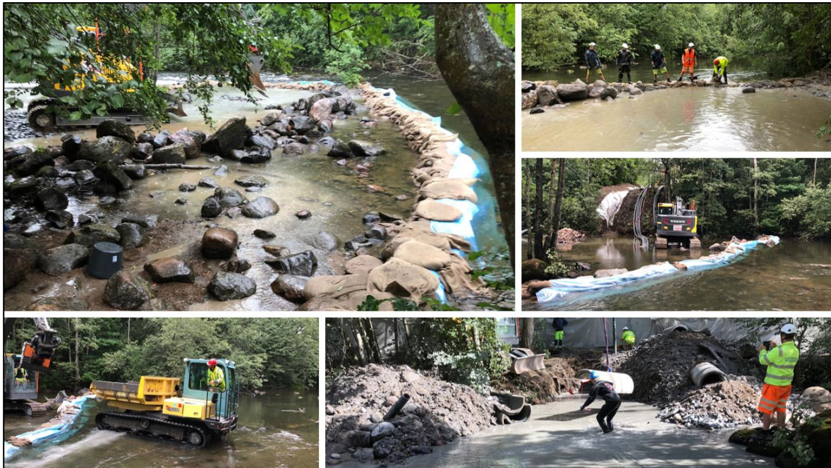
Figur 5. Kryssing av Akerselva med strømkabel var et utfordrende prosjekt som også inkluderte flytting av elvemusling og kreps. Foto: Hannu Stöckell, Veflen Entreprenør AS.
