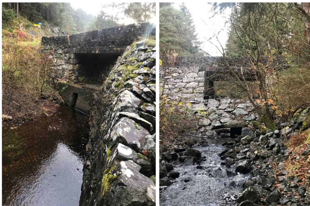
Figur 11 Bru ved Finnåsvegen. Elva renner inn gjennom en betongkulvert. Til venstre: innløp. Til høyre: utløp.
