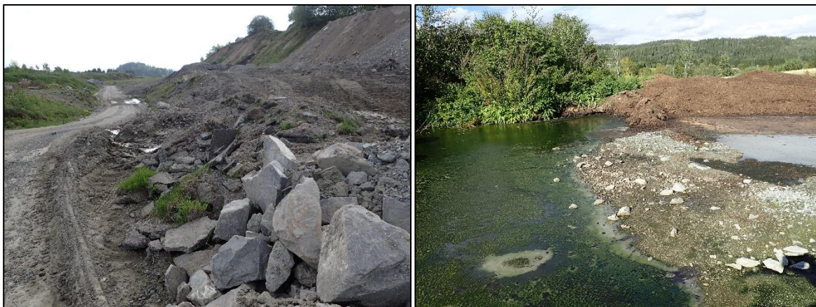
Figur 10. Massedeponi i tidligere massetak ved Sem gård, men også gjødseldeponi med potensiell avrenning direkte mot Semselva. Foto: Bjørn Mejdell Larsen.
