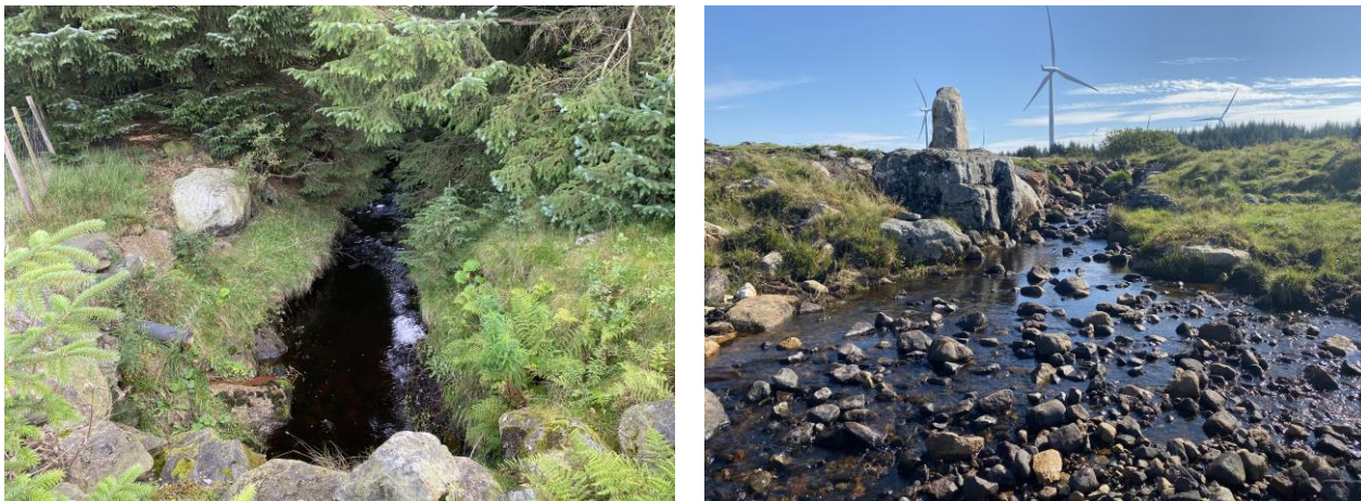
Figur 4. Til venstre kulverten oppstrøms veien og til høyre den samme kulverten nedstrøms veien. Foto: Kjell Sandaas 02.05.2022.
