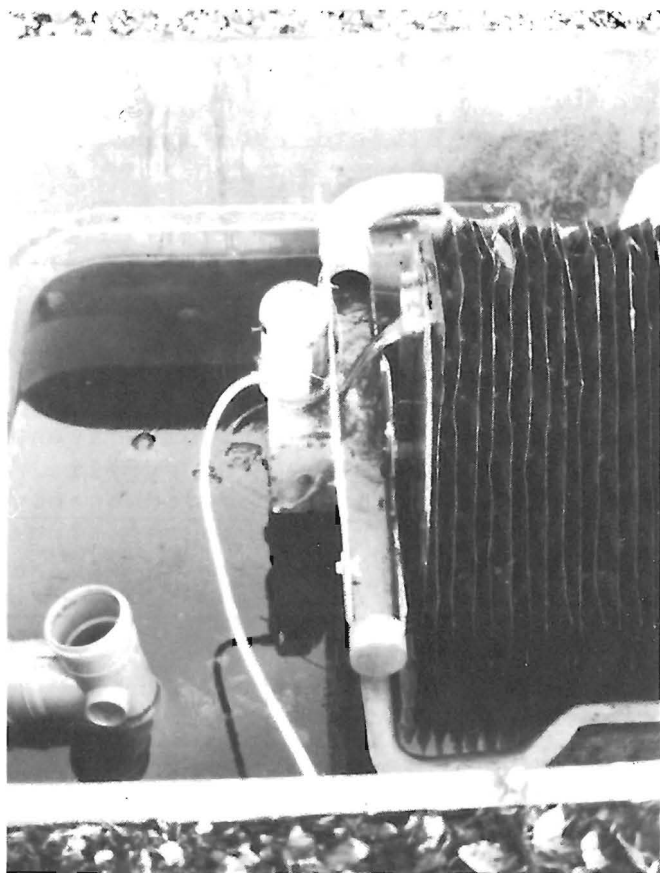
foto: Resirkulering, ettersedimentering og utløp.
