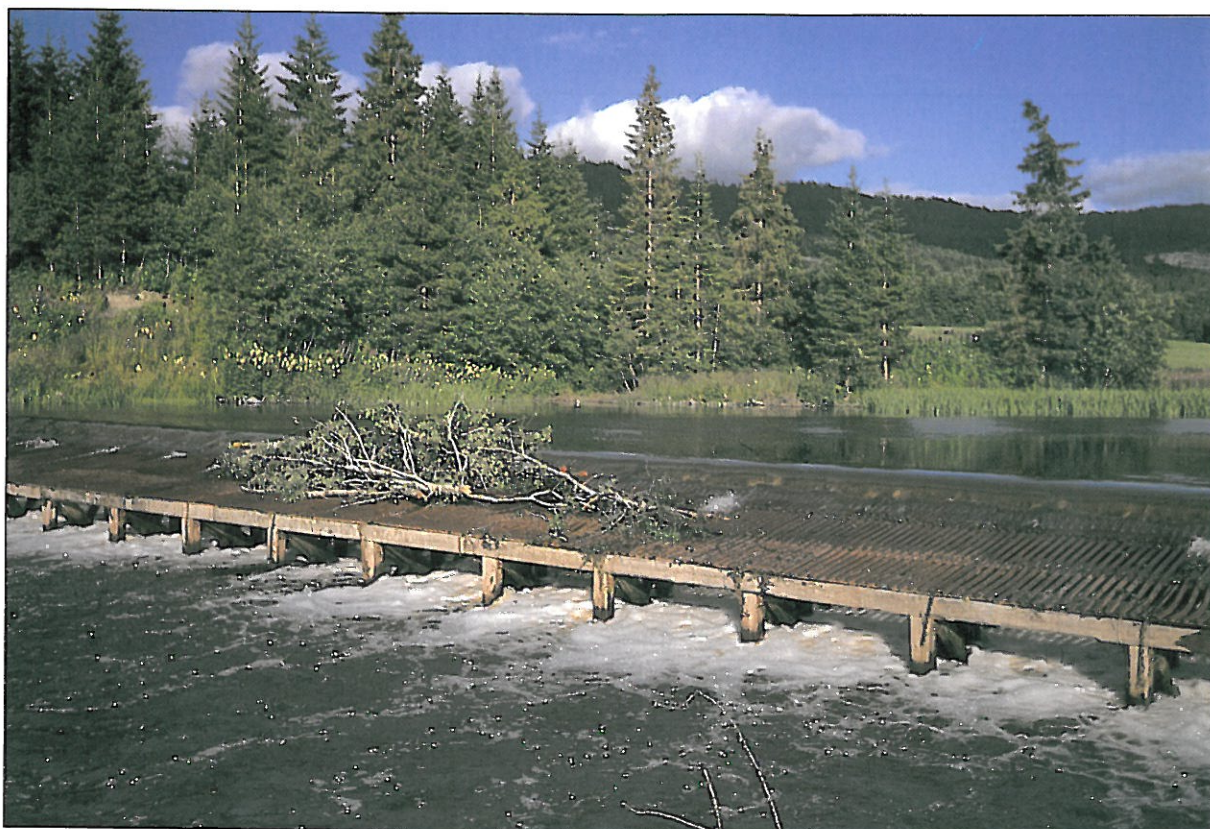
Bildet er tatt på høg sommervannstand. Ved hver økning av vannstanden legger det seg trær, røtter, rusk og rask på gitteret. Dette må fjernes med jevne mellomrom.
