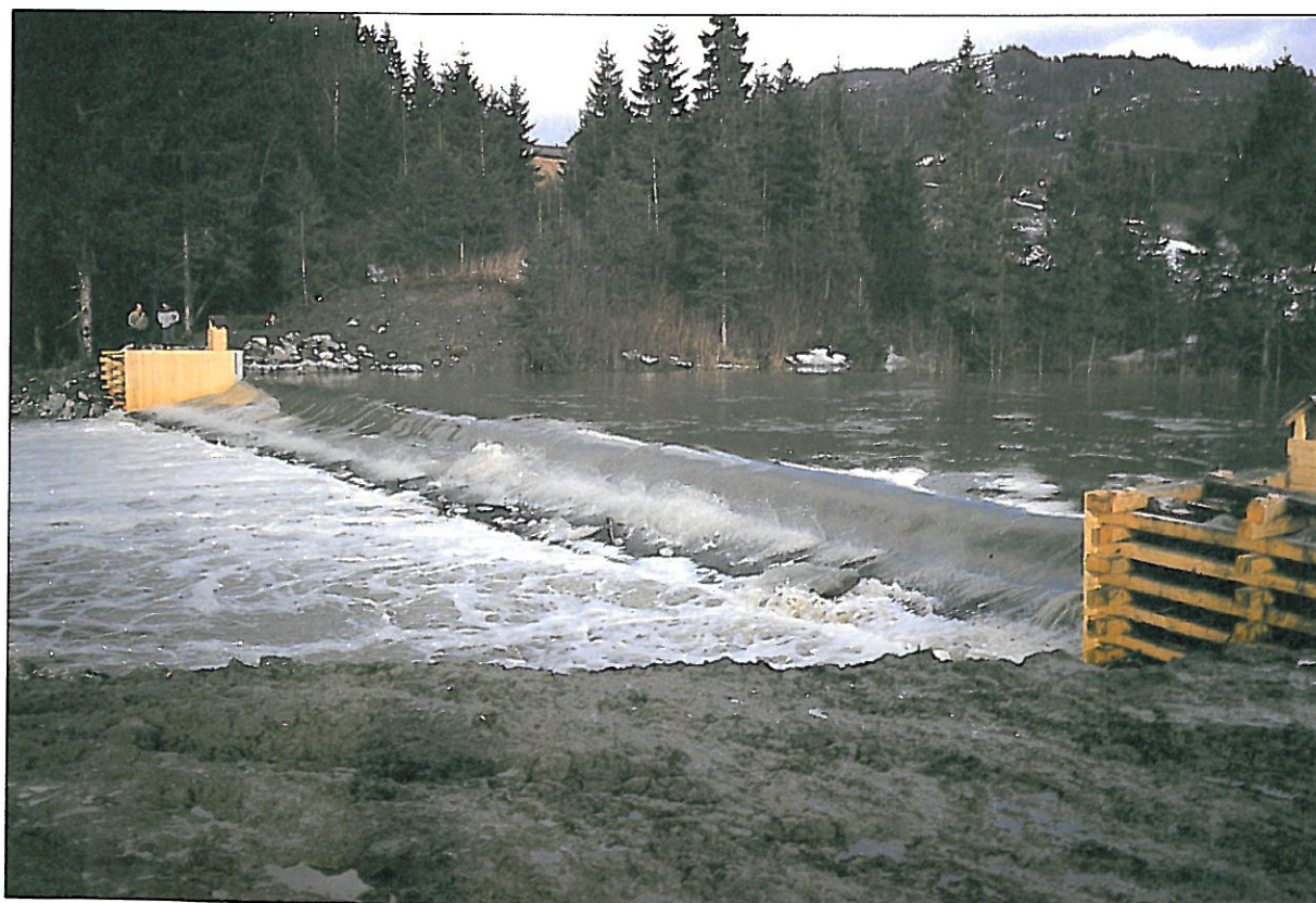
Fiskesperra sto ferdig i april 1988, dagen før flom og isgang satte inn. Flom og isgang har bare påført sperra mindre skader.
