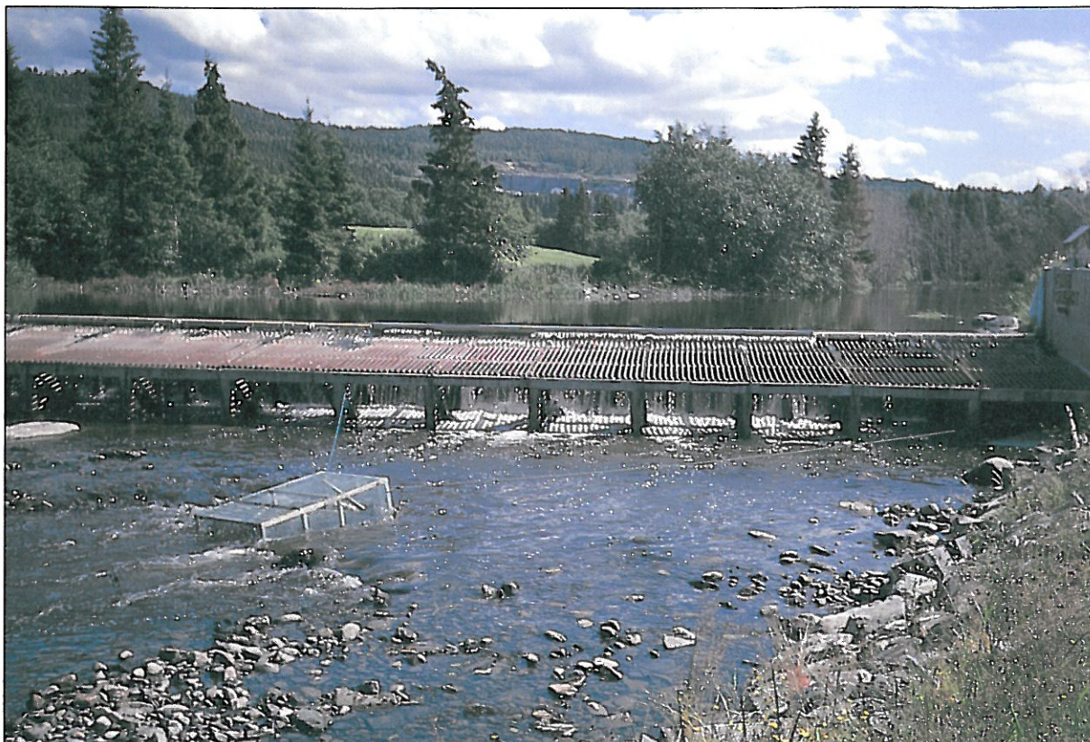
Bildet er tatt på liten sommervannstand. Vatnet siles gjennom et jerngitter med lysåpning på 5 cm. Gitteret er 4 meter bredt og deker sperra i hele sin lengde (38 meter).
