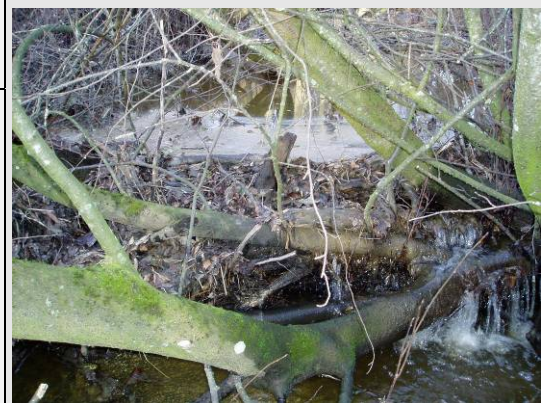
Vandringshinder like ovenfor utløpet til Verdalselva.
