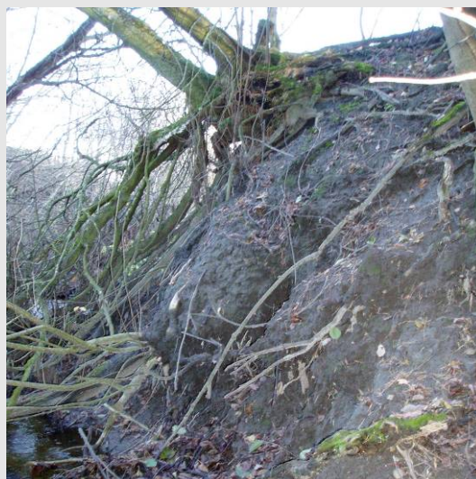
Erosjon har blottlagt røtter på trær som er i ferd med å legge seg over bekkeløpet.
