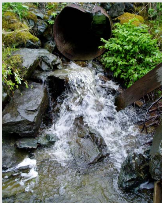
Bekkeløpet bør heves nedenfor kulverten i riksveien
