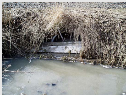
Betongdragere sperrer for kulverten.
