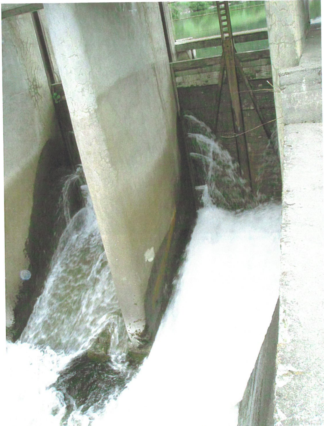
Bilde 8. To av lukene i dammen i Byafoss med åpning i en av dem.
