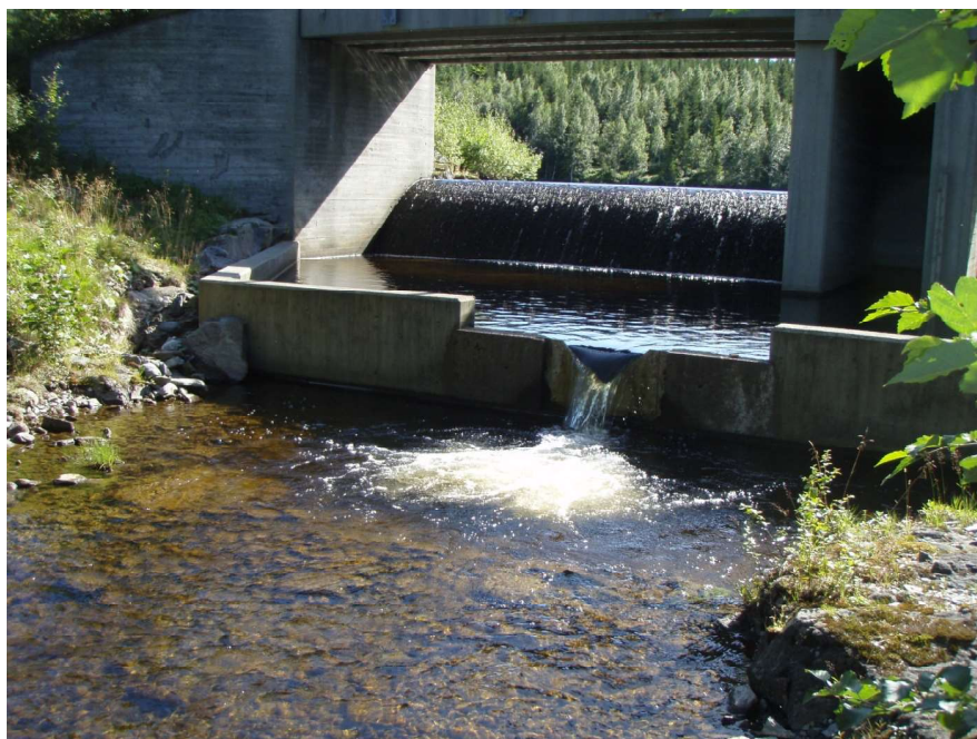
Foto 3. Reguleringsdam ved Åfjorden med V-overløp for måling av minstevannslipp. Foto Hans Mack Berger.
