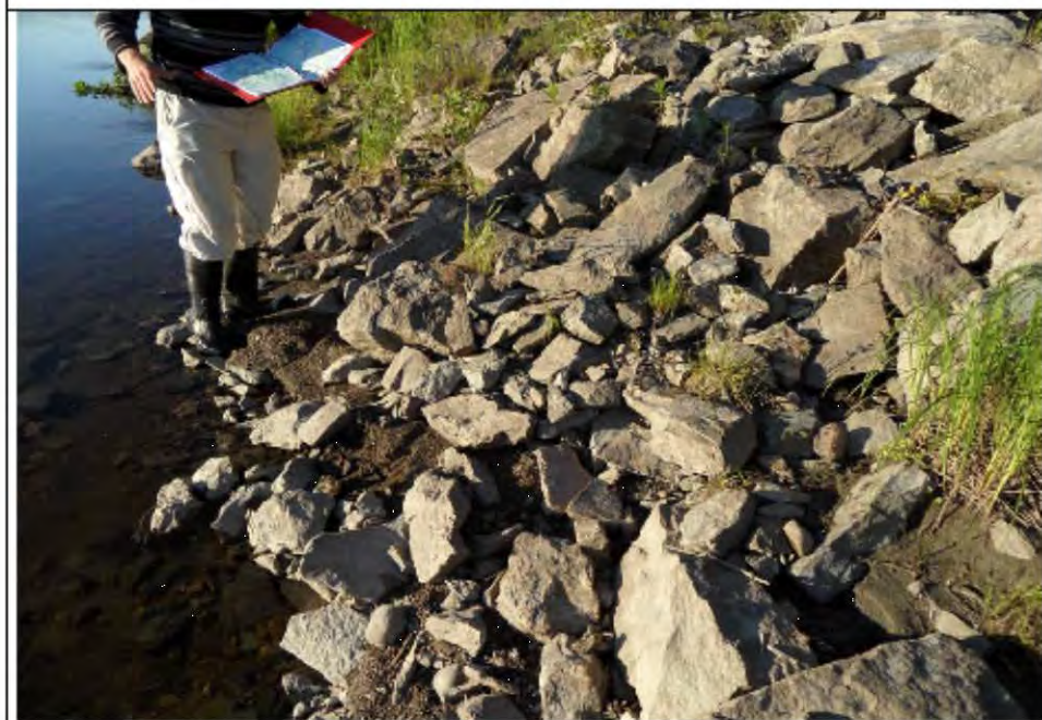
Bilde 2: Det kan være at det er forsøkt å etablere et utløp i forbygningen. Dette er tørrlagt.
