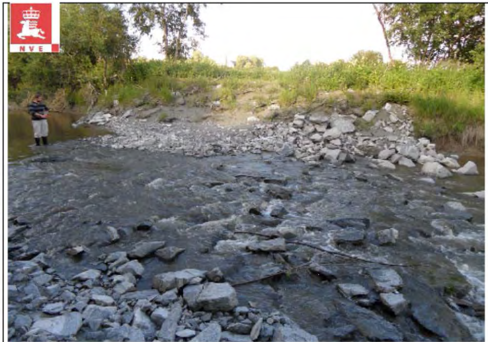
Bilde 1: Terskelen som er konstruert i utløpet av Reina er delvis ødelagt.
