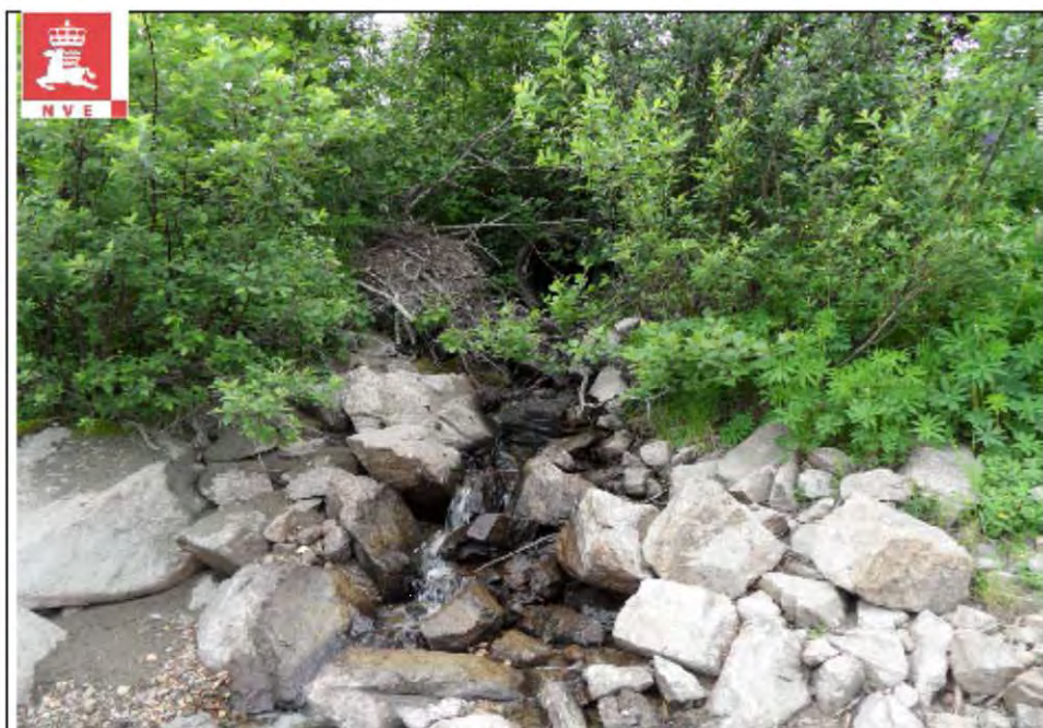
Bilde 1: Bratt stigning opp fra elva opp til delvis ødelagt kulvert. Elv ligger 2m nedenfor bildekant.
