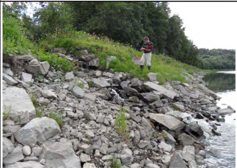
Bilde 2: Forbygningen i bunn av Klykkbekken er porøs/åpen, meget høy og gir en skarp fallgradient (3.5m høyde på 9m).
