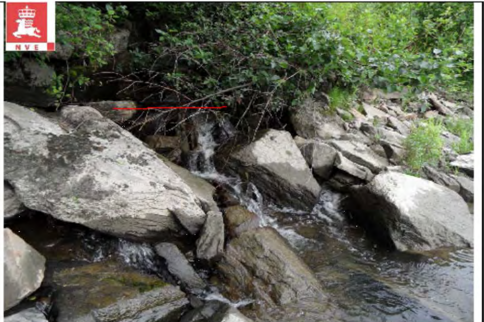
Bilde 1: Utløp Byabekken. Merk flommål. Vannspeil utenfor kulvert markert med rød linje. Vandringshinder ved flo, ca 30 - 50cm.
