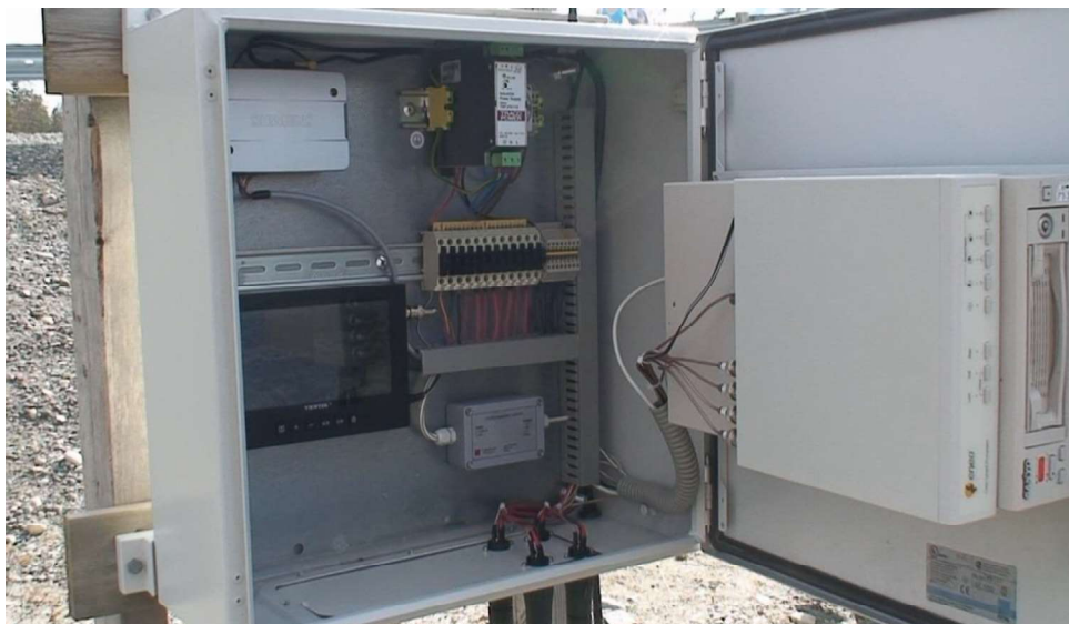
Figur 5. Elektroskap med videoopptakssystem.
