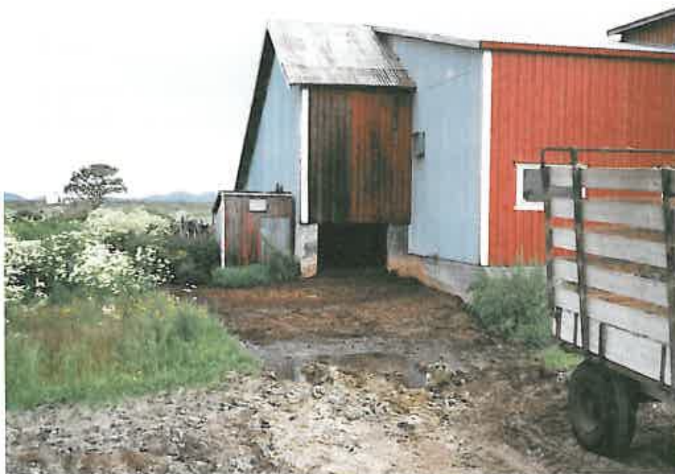
Lekkasje fra gjødselkjeller, behov for utbedring?
